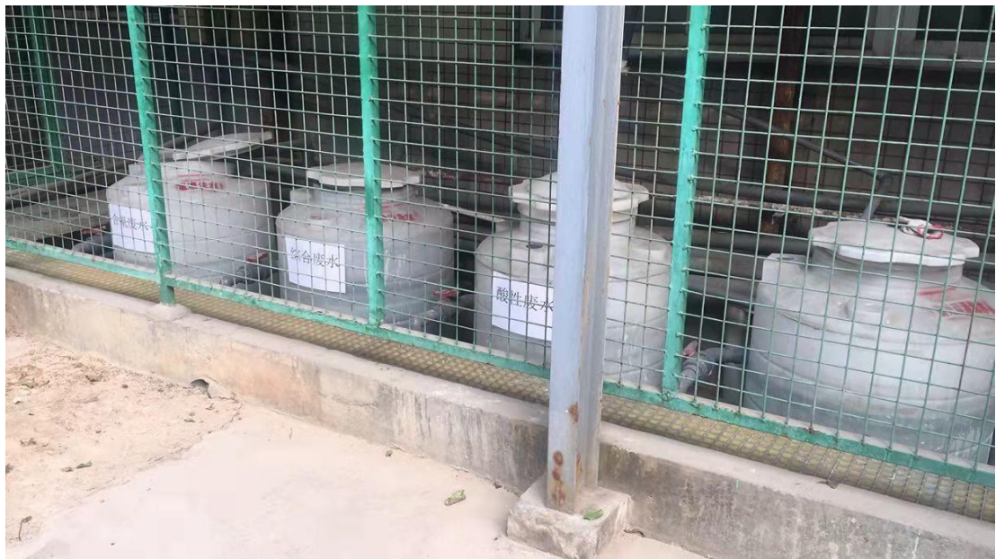
图 7.1-2 废水分类收集罐照片
